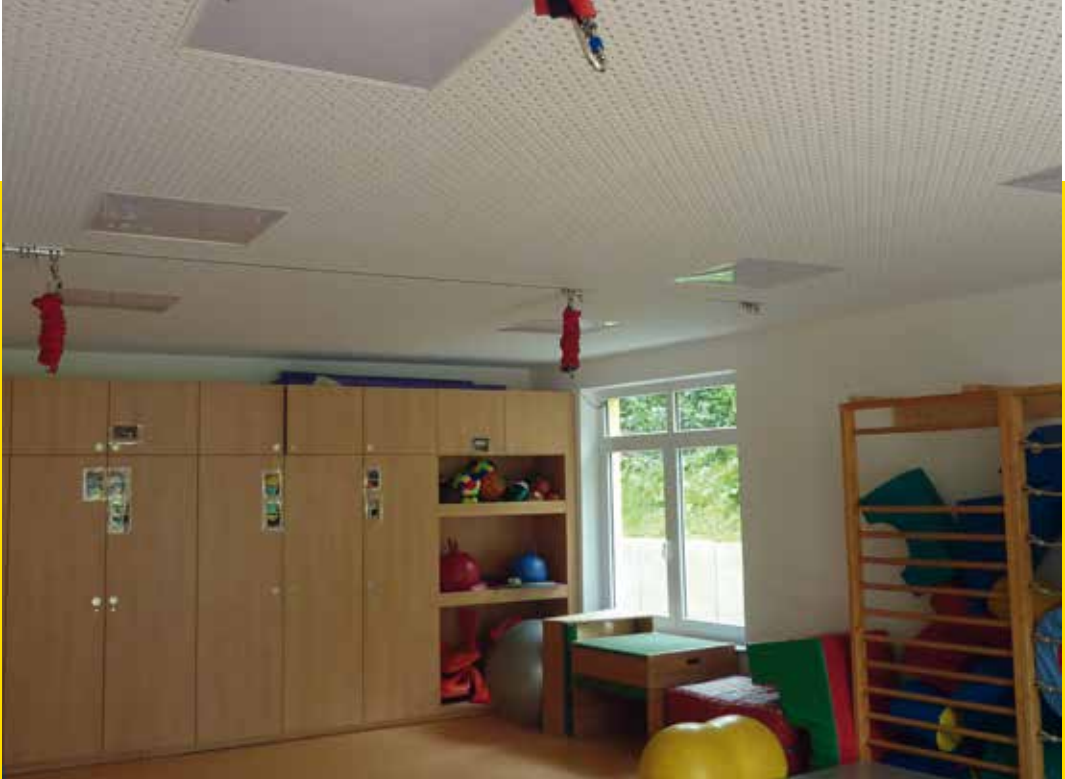
Schallabsorbierende Decke in einem Mehrzweckraum
